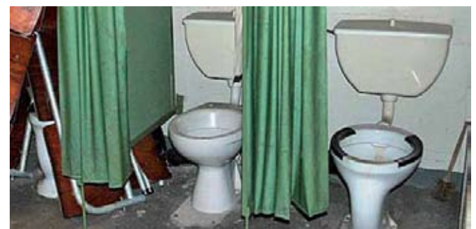
Katastrophale hygienische Zustände im Katastrophenschutz-Bunker
